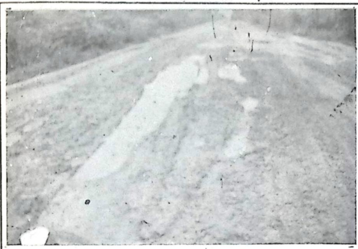
*** BURACOS, VALETAS, E A "ESTRADA" BR 267 ***
