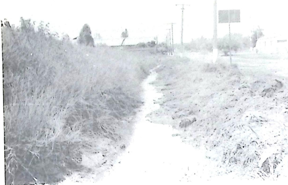
Vala aberta paralela à Avenida Teodoro Sativa para jogar a enchorradada que descia dos Bairros no Canal da Avenida
