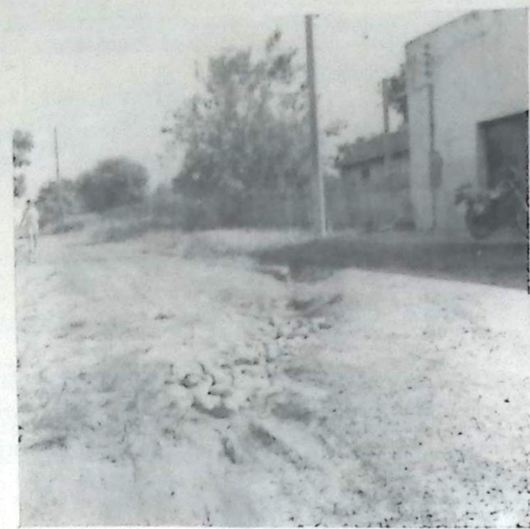
PEDRAS COLOCADAS POR MORADORES PARA DAR PASSAGEM NA RUA ROSALINO LINO
