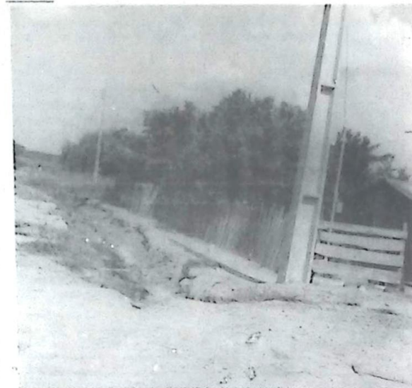
A VALA FEITA NA RUA ARIOSTO SILVEIRA LINO IMPEDE A CHEGADA DOS MORADORES
