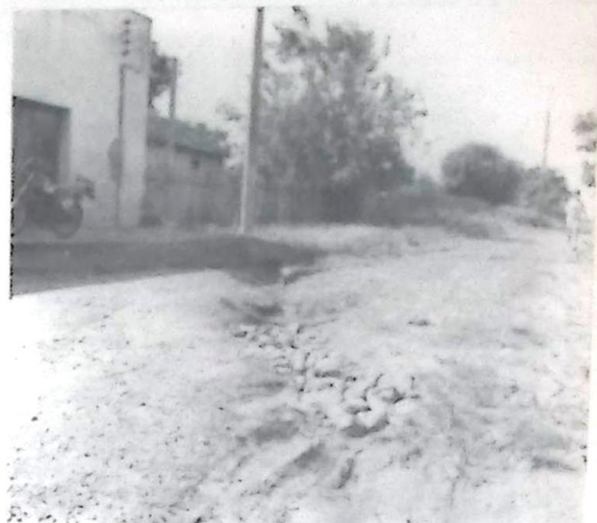
PEDRAS COLOCADAS POR MORADORES PARA FAZ PASSAGEM NA RUA ROSA LINO LINO
