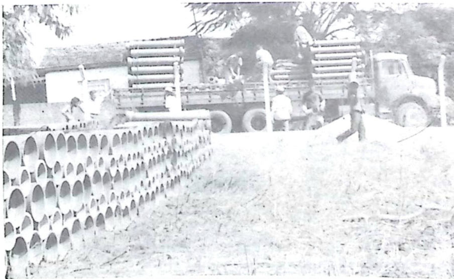
MATERIAIS DO ESGOTO SENDO DESCARREGADOS NA VILA COHAB
