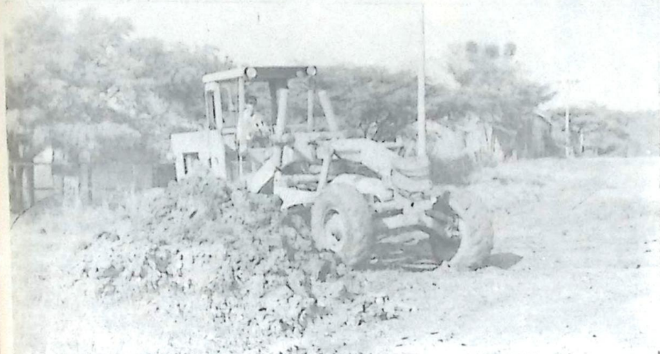
"Mimito" determinou mobilização total da Secretaria de Obras para reparar com urgência estradas causados pelas chuvas
