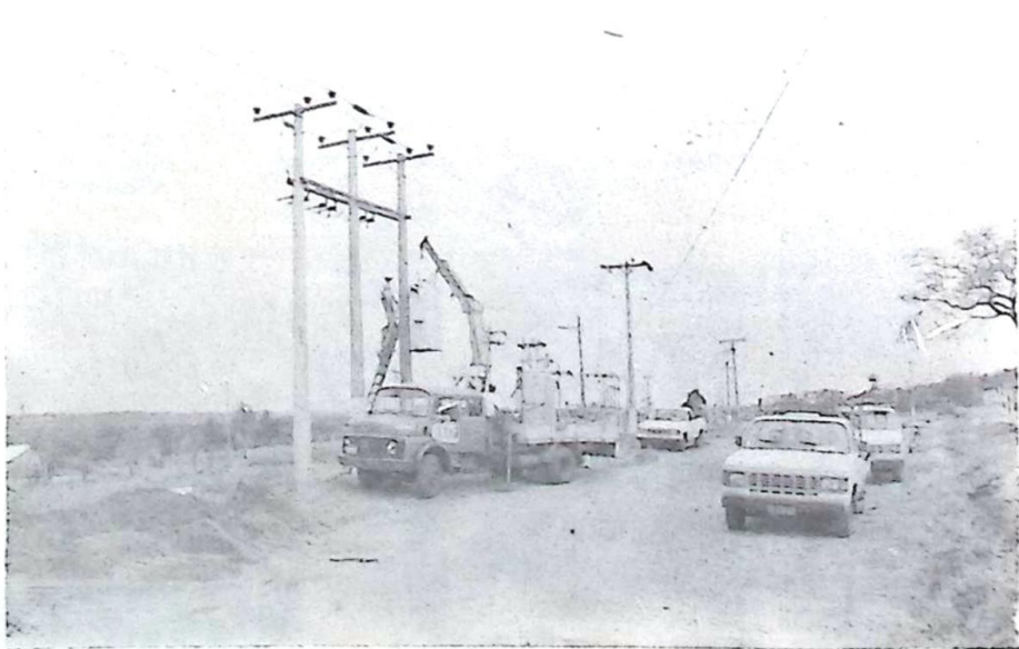
Os reguladores de tensão instalados vão proporcionar uma melhoria na qualidade da energia distribuída para Bela Vista, Caracol e região
