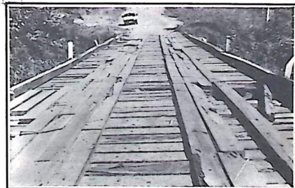
Pontes em péssimas condições
