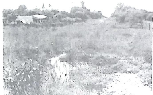
Aqui, antigamente era uma RUA TRANSITÁVEL, e, em vez dessa lagoa, havia uma ponte que foi deteriorada na gestão passada
