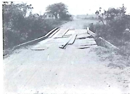
Um registro das precárias condições em que se encontra a ponte
