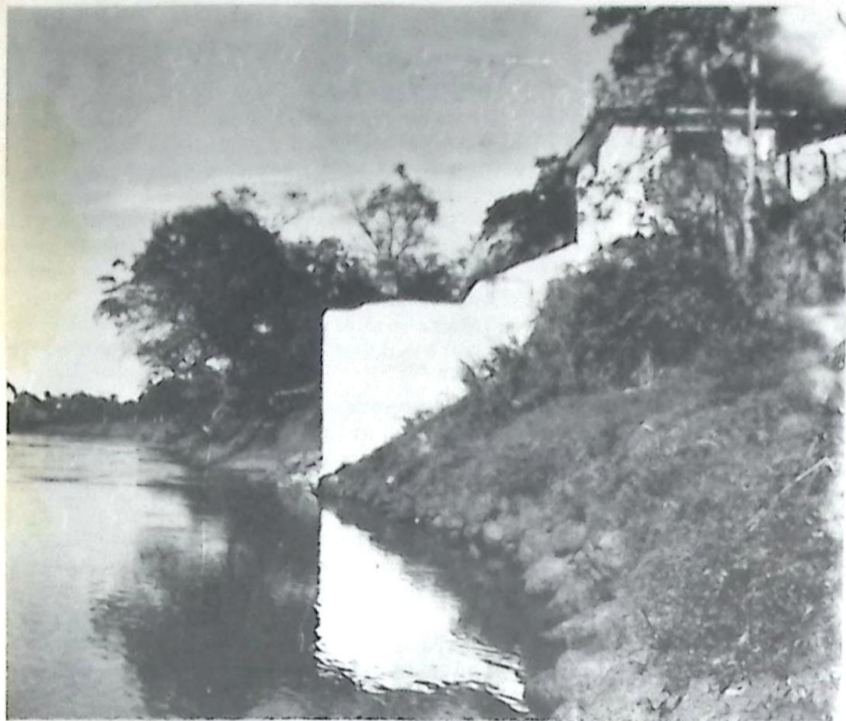
A obra de Contenção de Enchentes na Estação de Captação do SAAE no Rio Apa
