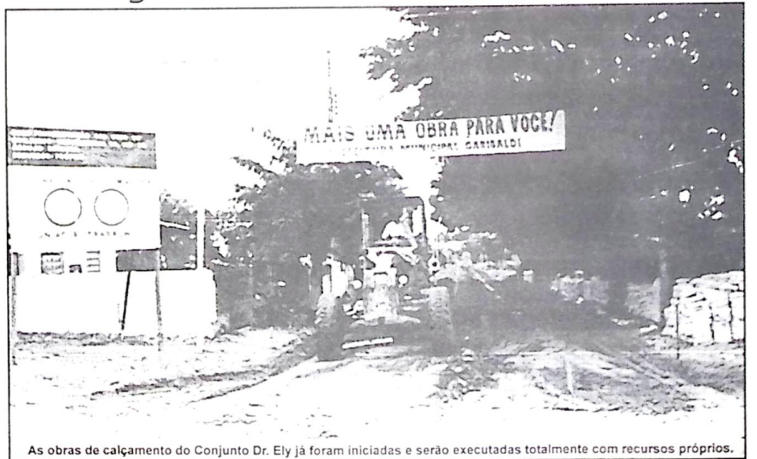
As obras de calçamento do Conjunto Dr. Ely já foram iniciadas e serão executadas totalmente com recursos próprios.
