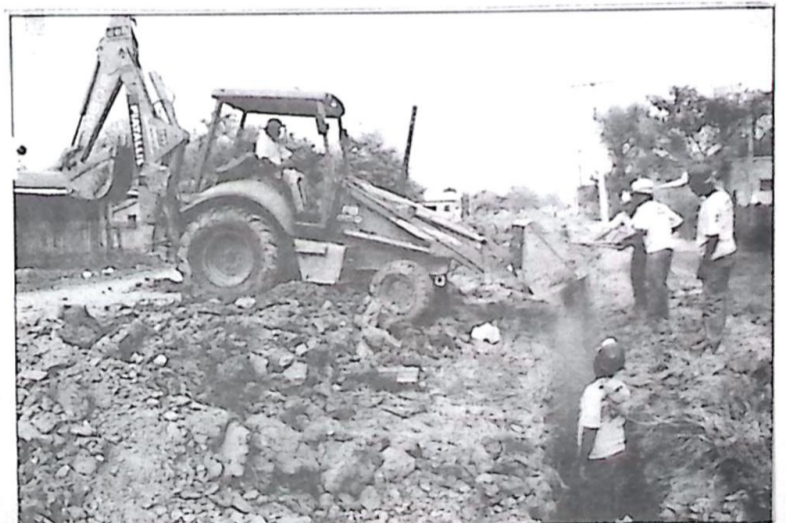
O poder público em Murtinho investe pesado na infra-estrutura, educação e saúde, aqui maquinários e homens trabalhando na obra do esgotamento sanitário
