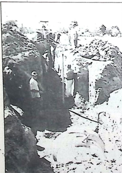
Execução de Sistema de esgotos sanitários em parceria com a FUNASA as margens do Rio Apa e bairro Espírito Santo
